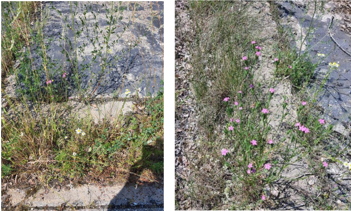
Abbildung 21: links Pioniere aus Ritzen bei Betonbecken 4, rechts Raue Nelke ( Dianthus armeria ) innerhalb eines Betonbeckens, Jost 2024
